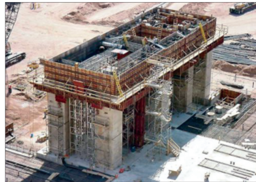
Los productos de T&B ayudarán a finalizar la expansión de mil millones de dólares de la central eléctrica de Springerville (Arizona).
