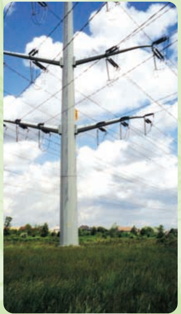
Soporte de anclaje Meyer™ utilizado en los circuitos de las redes transportadoras de alto voltaje adyacentes al área metropolitana de Chicago de 345kv.
